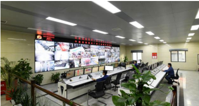
华菱湘钢棒材厂三线集中控制室
