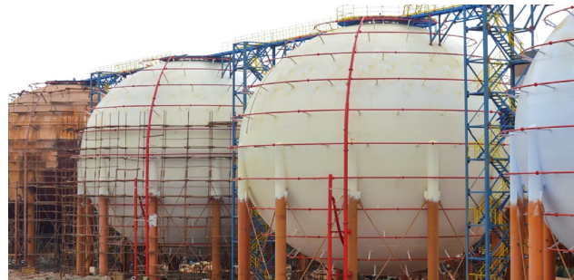
▲ 宁波海越球罐群——亚洲最大球罐群项目，采用公司压力容器用钢
