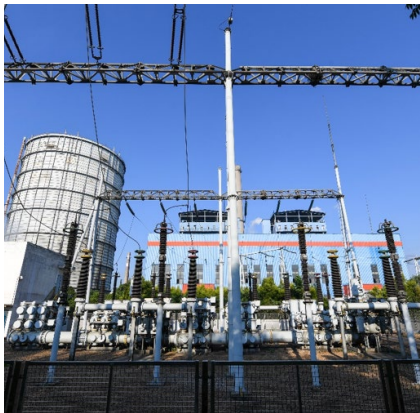
▲ 华菱湘钢 135MW 瓦超高压余能发电项目
