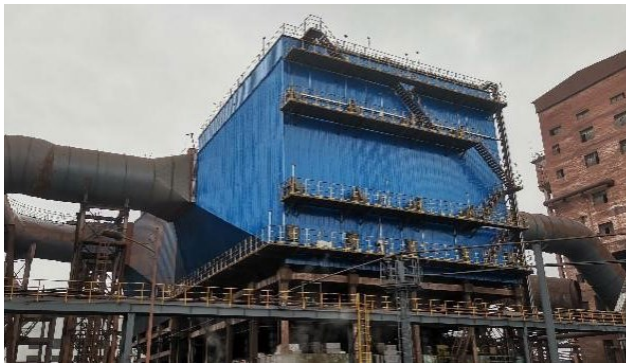
烧结电除尘系统
