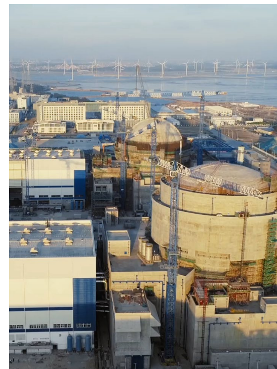
▲ 中核集团福清核电项目——“华龙一号”全球首堆，采用公司核电用管
