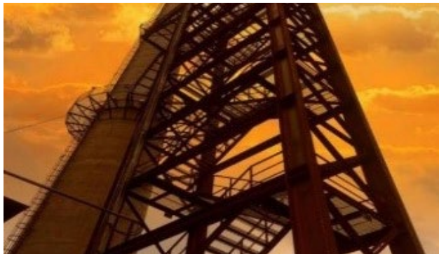
在线监测采样平台
