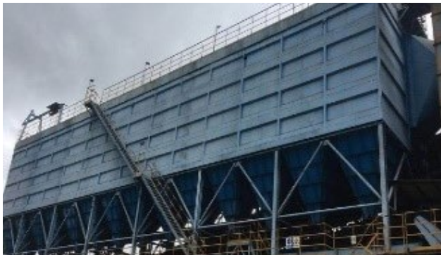
原料场布袋除尘系统
