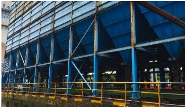
高炉布袋除尘系统
